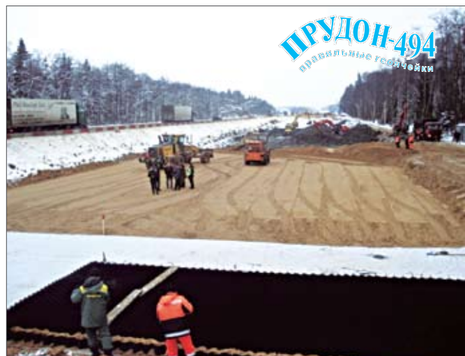
Федеральная автодорога М-1 «Беларусь»
